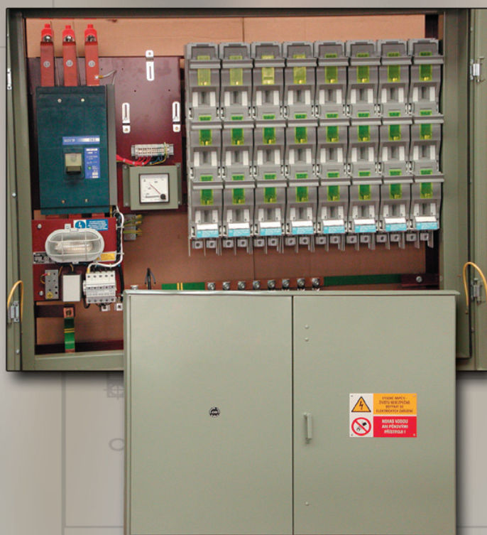
ROZVÁDĚČ RST 0663/4835 VE SKŘÍŇI SVS - ZT10
