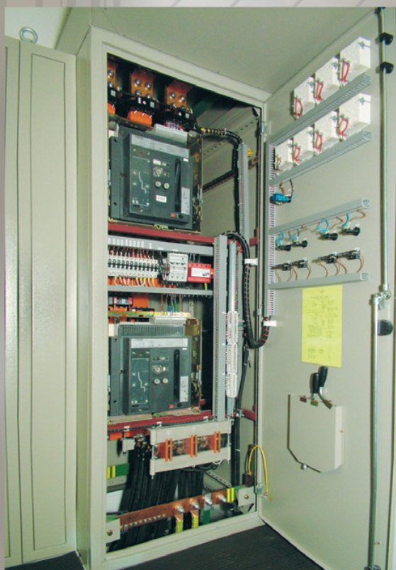
Přívodní pole rozváděče
